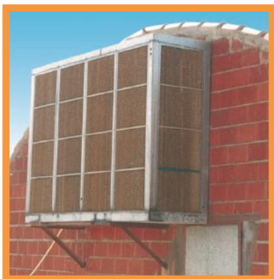
Caseta refrigeración con estructura Inox.
